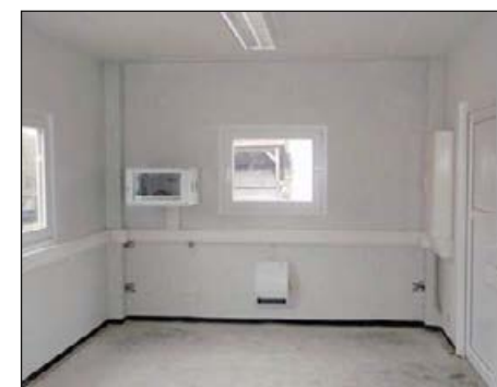
Abb. 3: Innenansicht des Betoncontainers mit elektrischer Installation
